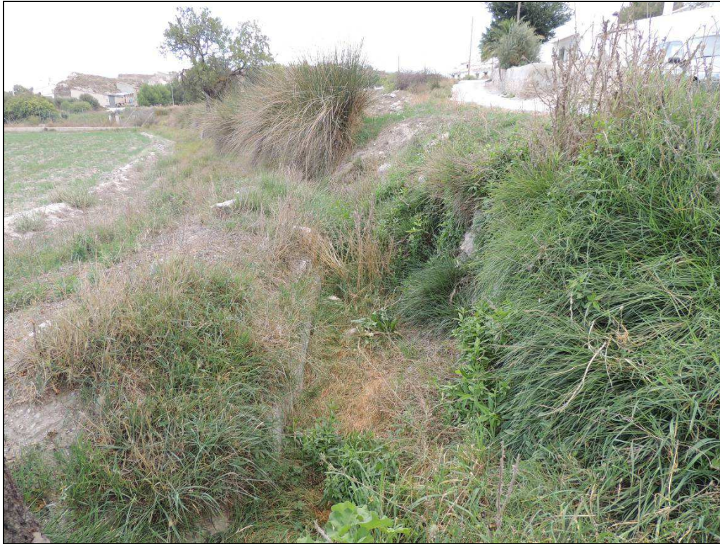
Acequia del Pago del Nacimiento, después de la zona hormigonada, sin presencia de agua. Se encuentra totalmente cegada por la vegetación herbácea y arbustiva.
